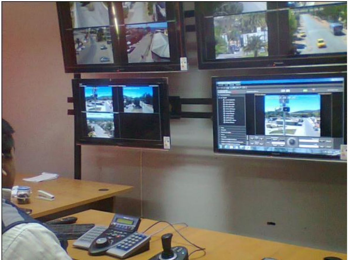
CAMARAS ESTABLECIDAS Y OPERATIVAS.
